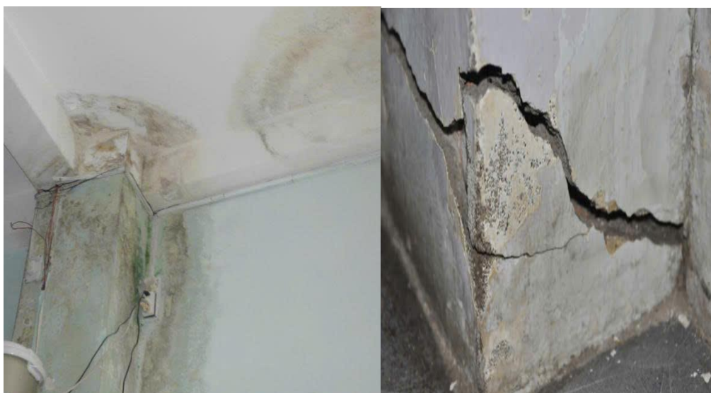
Rò rỉ làm ẩm tường và đứt gãy mảng tường
